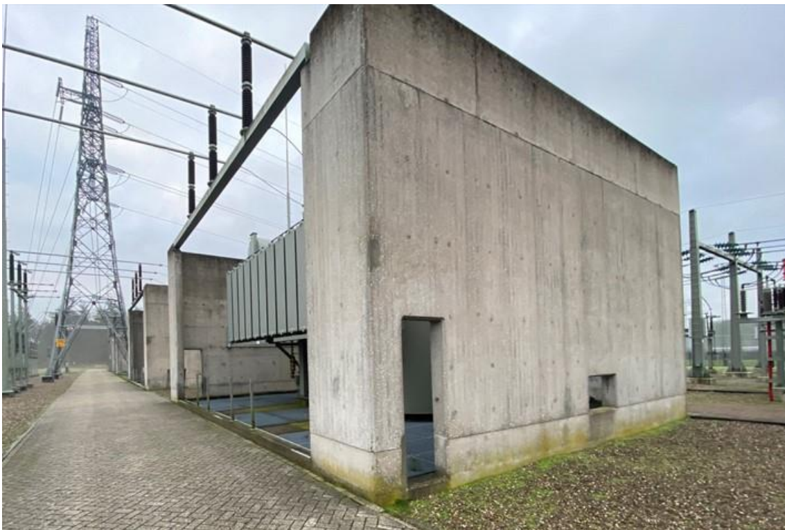
afbeelding 19: bestaande transformatorruimte in het plangebied
