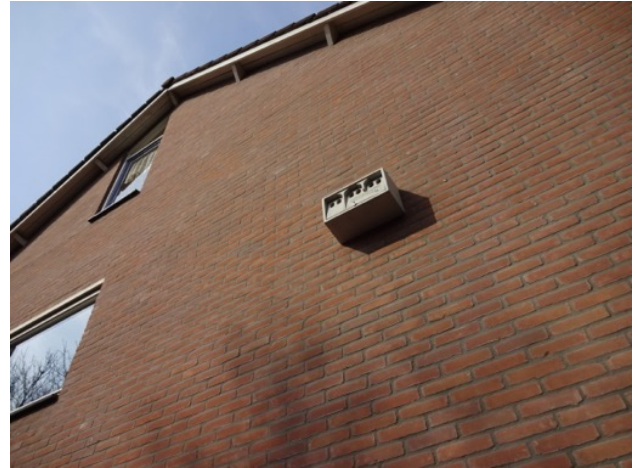
zijgevel met mussenkast
