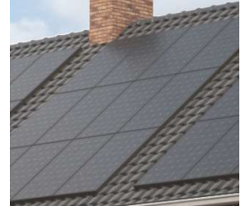
'Op dak'-systeem, all-black PV-panelen
