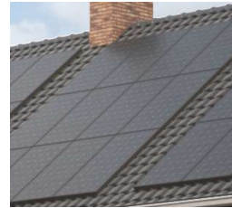
'Op dak'-systeem all-black PV-panelen
