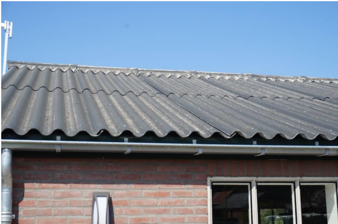
Figuur 5.3. Golfplaten dak voorzien van vogelschroten, zonder invliegopeningen.
