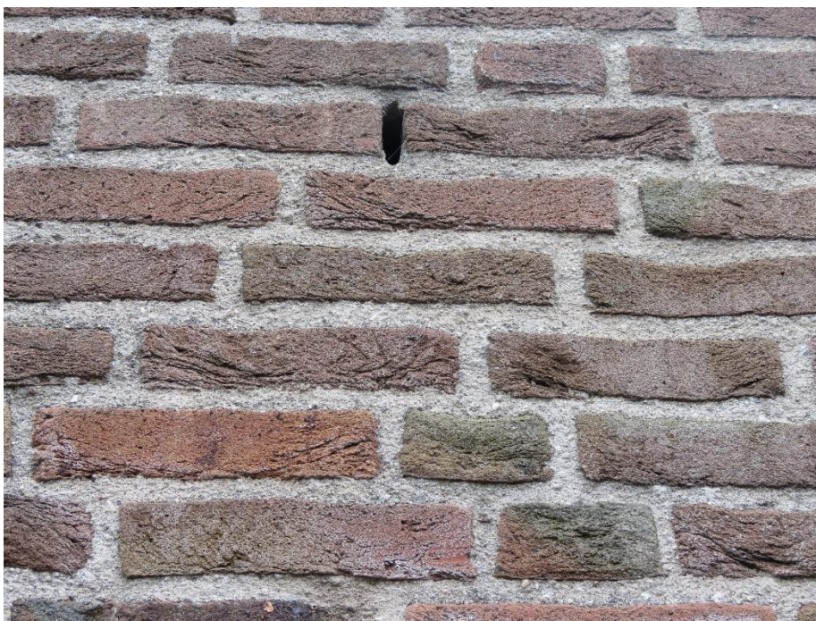
Open stootvoegen en scheuren in metselwerk
