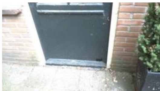
Foto 2 | plaat op de buitendeur
