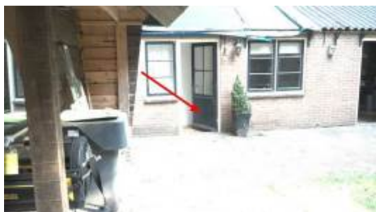
Foto 1 | plaat op de buitendeur
