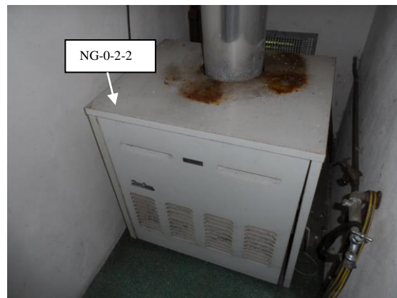
Foto 2: Asbesthoudende cv-ketel in cv-ruimte. (voorzijde)
