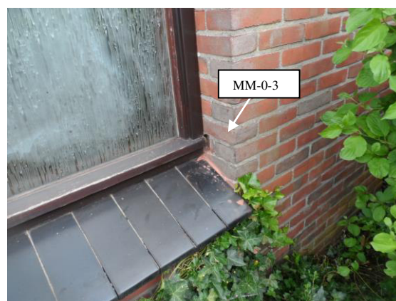
Foto 6: Asbesthoudend plaatmateriaal als spouwstrook t.p.v. 6 raamkozijnen in zijgevels.
