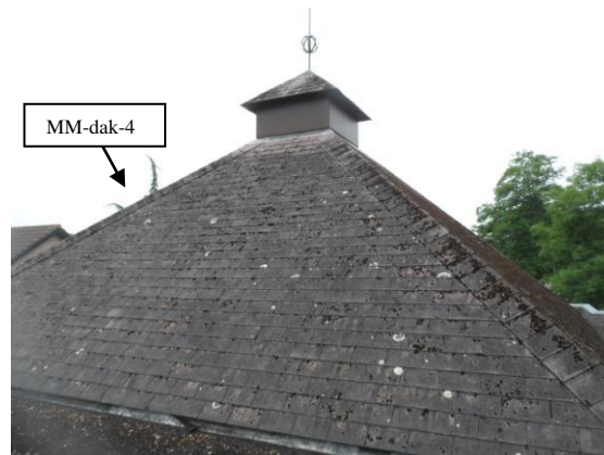
Foto 8: Asbesthoudende leien als dakbedekking van kerkgebouw.
