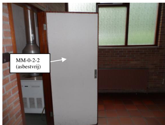
Foto 4: Asbestvrij plaatmateriaal op deur van cv-ruimte (voorzijde)
