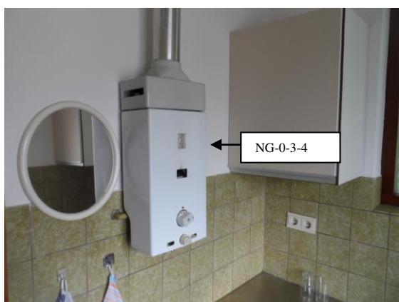
Foto 5: Asbesthoudende geiser in keuken.
