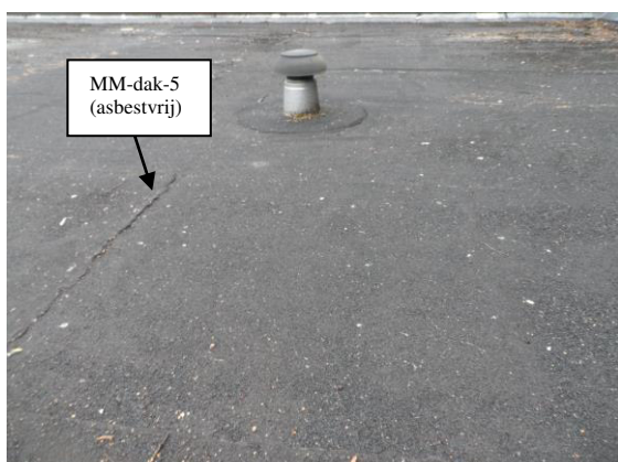
Foto 9: Asbestvrije bitumineuze dakbedekking t.p.v. gedeelte van kerkgebouw met plat dak.
