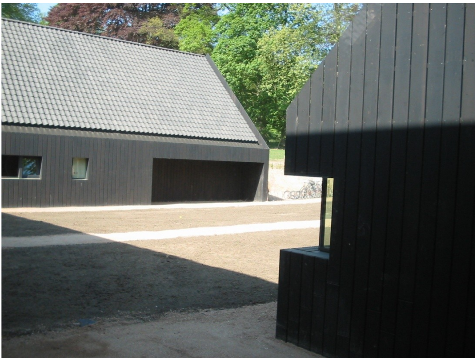
Schuren bij bezoekerscentrum Veluwezoom, Rheden: niet-traditionele detaillering van goten, gevelbetimmering, dakranden en raamopeningen.
