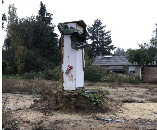
Afbeelding 7. Restanten van het gebouwtje, met nog aanwezige bedrading.
