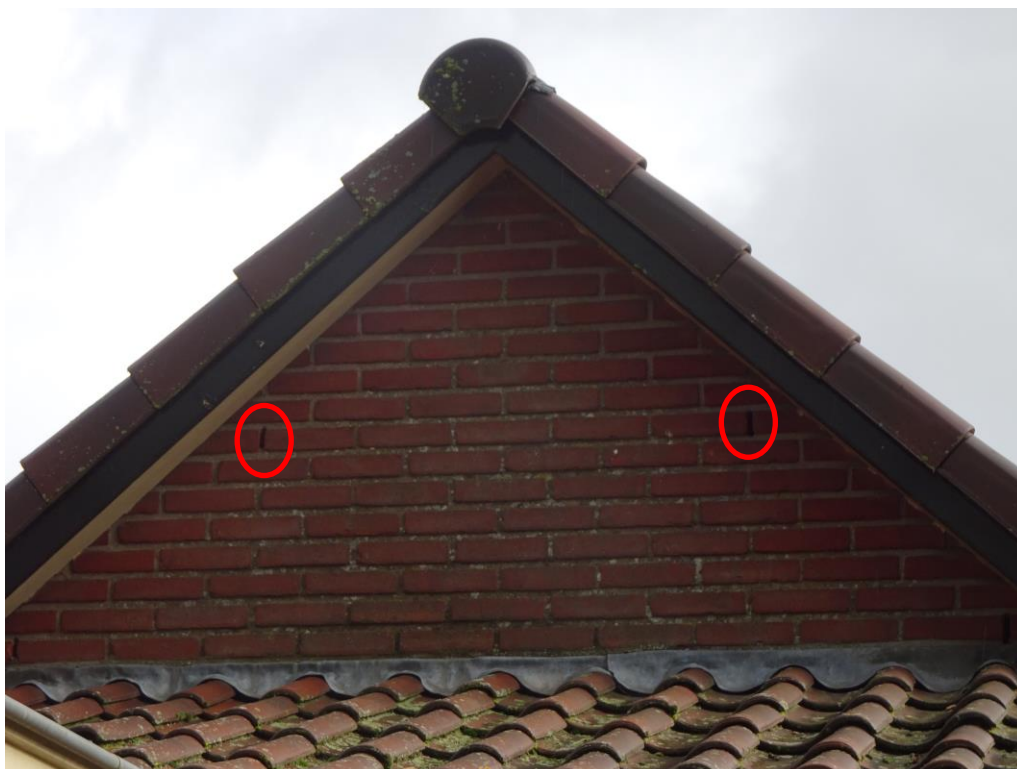
Open stootvoegen in een aanbouw aan de zuidzijde van het woonhuis.
