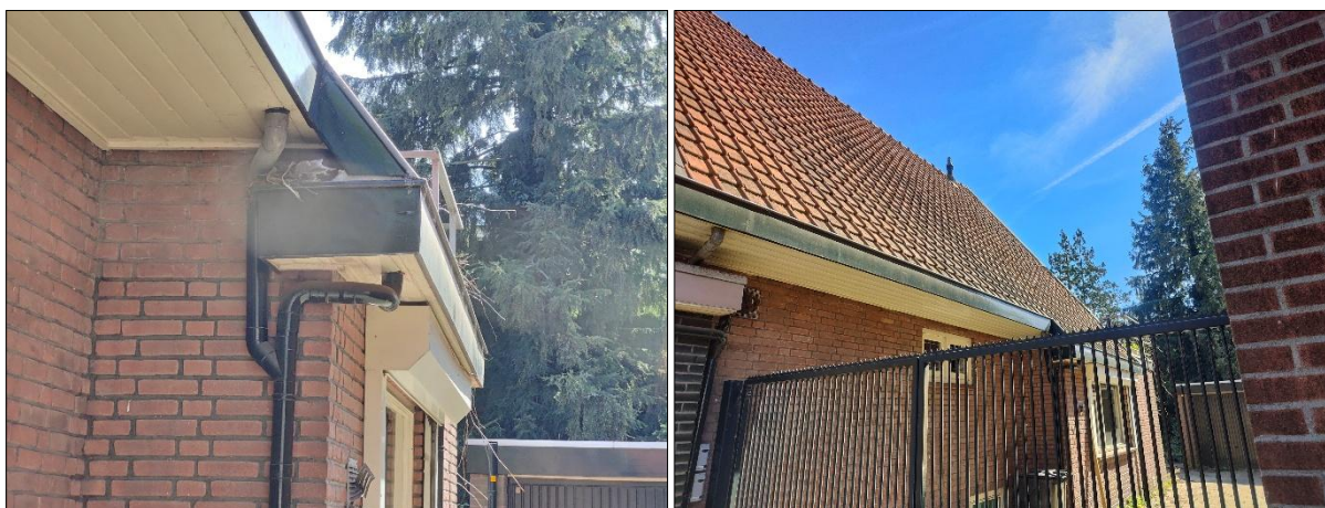
Links; nest van hout- of tortelduif. Rechts; Dak is ongeschikt voor huismussen en gierzwaluwen door type pan en dakgoot, en strak aansluitende pannen en nokvorsten.
