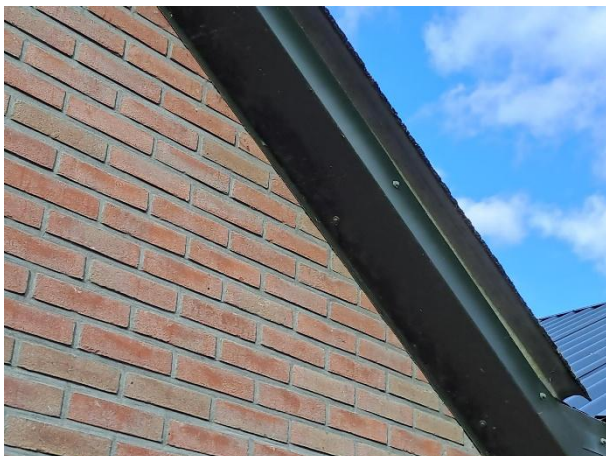
Foto: gevel sluit goed aan op dakoverstek..
