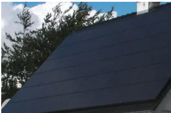
Zonnepanelen zijn logisch, in een grid-opstelling geïnstalleerd, bij voorkeur 'full black', waardoor ze opgaan in de zwarte kleur van de dakpannen.
