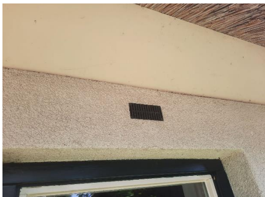
Figuur 5.3: geen kieren tussen gevel en rieten dak
