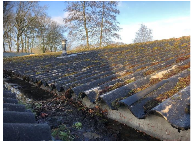
Foto 20: aansluiting dakplaten aan goot (foto Botani-Specialist)
