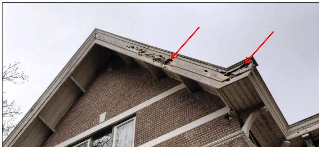
Grote gaten in het hout van de windveer kunnen gierzwaluwen toegang geven tot potentiële nestplaatsen.
