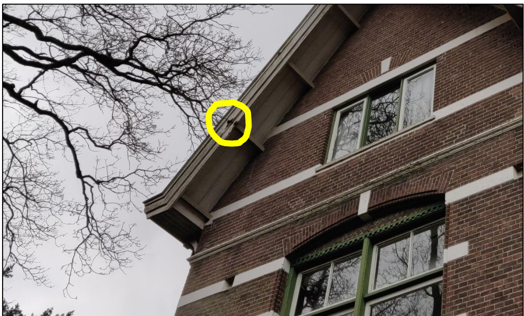
Locatie 4, invliegopening is gat in windveer in westelijke dak aan de zuidzijde van De Wissel.
