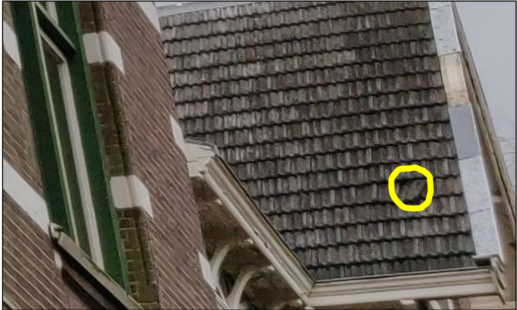
Locatie 3, invliegopening bij scheef liggende dakpan in oostelijk dakdeel aan de zuidzijde van De Wissel, in de buurt van locatie 1.
