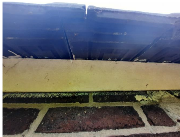
Figuur 5.5: geen kieren onder dakpannen
