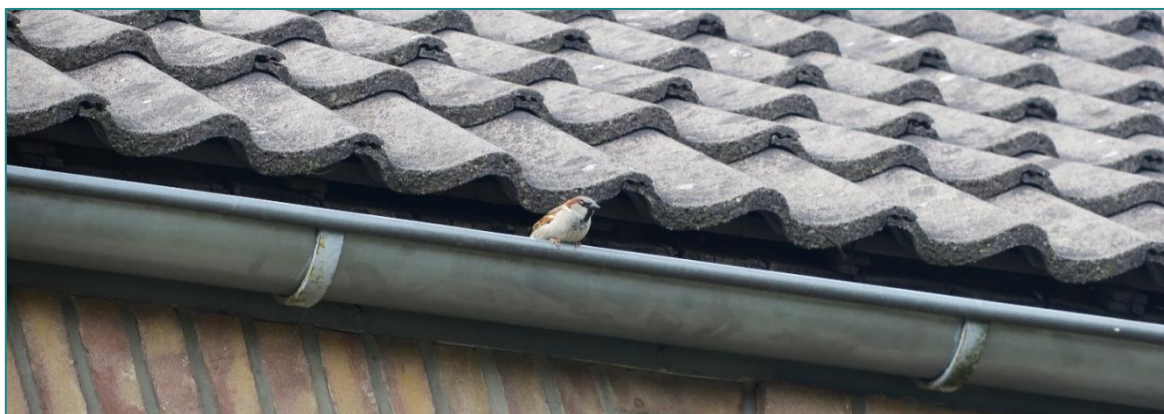
Figuur 3.2 Nestbetreding waargenomen van huismus onder dakpan aan dakvoet.
