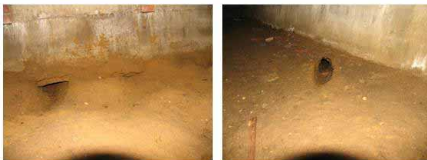
Afbeelding 3: graafsporen van konijnen in de kruipruimte onder het huidige schoolgebouw.
