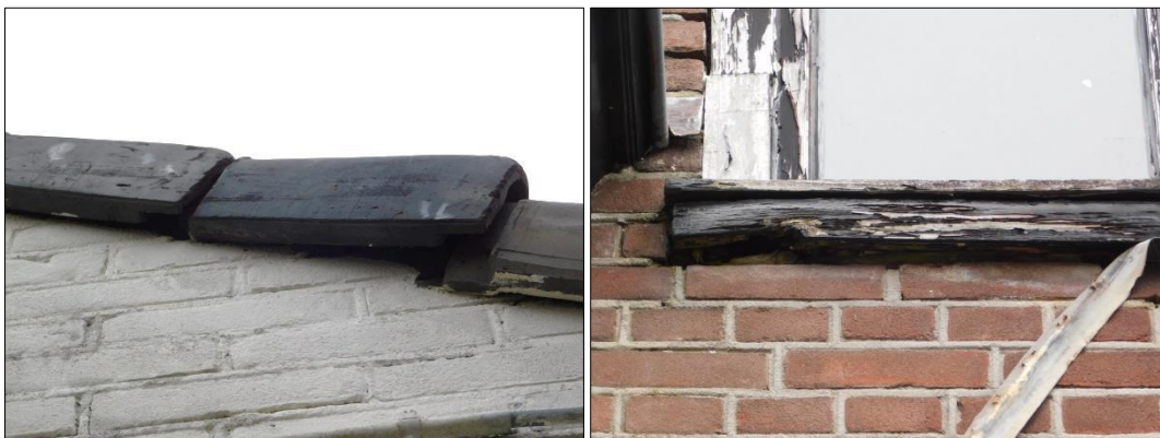
Foto's 7 en 8. Links een losse kantpan aan de achterzijde van het winkelpand. Rechts een ruimte tussen kozijn en de muur aan de achterzijde van het winkelpand.
