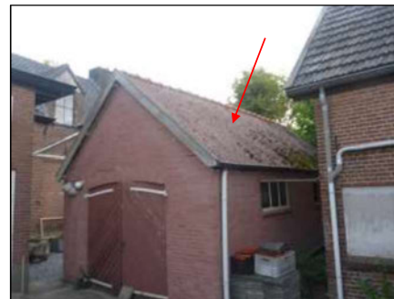
Foto 15: Garage: Golfplaten dak incl. overlap & toebehoren (Bron 4) (Asbesthoudend) Zie conclusie hoofdstuk 7.
