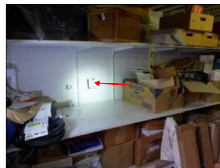
Foto 29: Opslag, begane grond: Wandbeplating (Bron 14) (Asbesthoudend)
