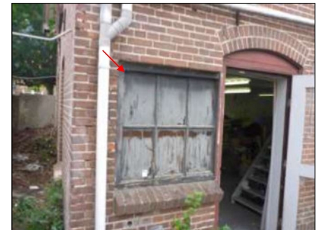
Foto 40: Opslag: Stopverf (Bron 7) (Asbesthoudend)
