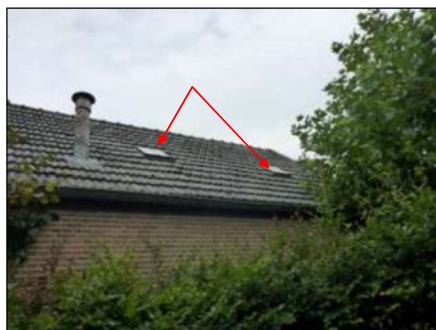
Foto 48: Opslag: Stopverf (Bron 7) (Asbesthoudend)
