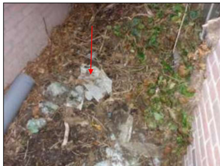
Foto 22: Tussen garage en opslag: Restanten buis (Bron 11) (Asbesthoudend)
