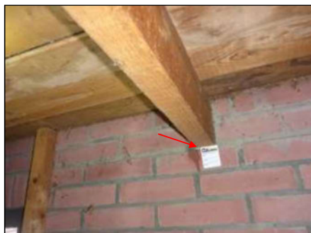
Foto 19: Garage, binnenzijde: Vulplaatjes (Bron 5) (Asbesthoudend) Zie conclusie hoofdstuk 7.
