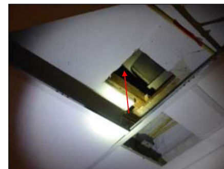
Foto 90: Pand: Dakbeschoot (Bron 9) (Asbesthoudend) Zie conclusie hoofdstuk 7.
