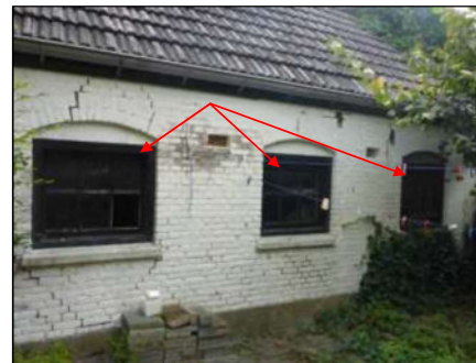
Foto 99: Schuur: Stopverf (Bron 18) (Asbesthoudend)
