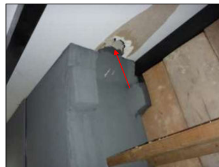
Foto 75: Pand, 1° etage, keuken: Wandbeplating (Bron 19) (Asbesthoudend) Zie conclusie hoofdstuk 7.
