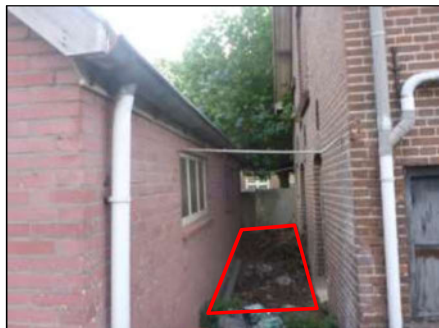
Foto 21: Tussen garage en opslag: Restanten buis (Bron 11) (Asbesthoudend)
