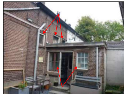
Foto 51: Winkelpand: Stopverf (Bron 17) (Asbesthoudend)
