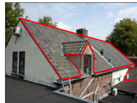
Foto 102: Pand: Dakbeschoot (Bron 9) (Asbesthoudend) Zie conclusie hoofdstuk 7.
