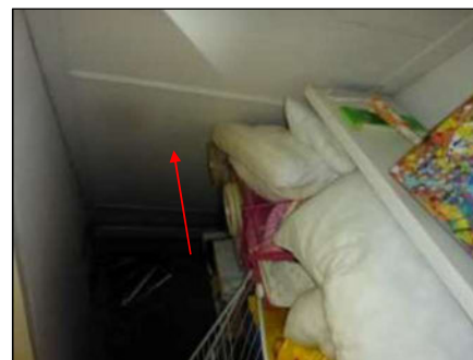
Foto 53: Pand, onderzijde trap: Trapbekleding (Bron 16) (Asbesthoudend)
