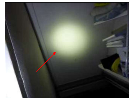
Foto 54: Pand, onderzijde trap: Trapbekleding (Bron 16) (Asbesthoudend)
