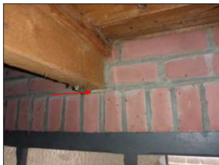
Foto 20: Garage, binnenzijde: Vulplaatjes (Bron 5) (Asbesthoudend) Zie conclusie hoofdstuk 7.
