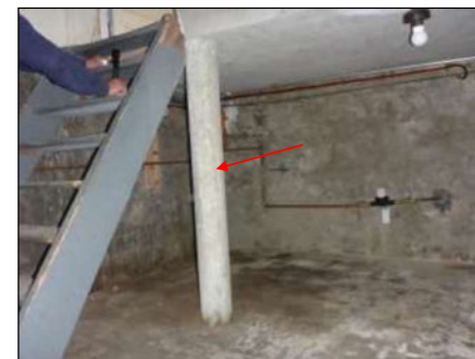
Foto 86: Kelder: Funderingspaal (Bron 13) (Asbesthoudend)
