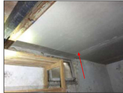
Foto 61: Pand, kelder: Verloren bekisting (Bron 9) (Asbesthoudend) Zie conclusie hoofdstuk 7.
