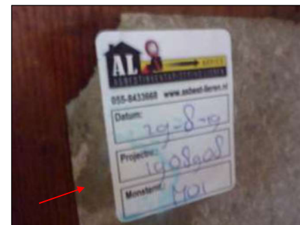
Foto 4: Opslag, 1 e etage: Plafondbeplating (Bron 1) (Asbesthoudend)
