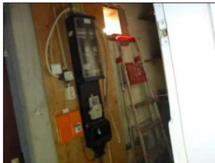
Foto 94: Meterkast (Niet asbestverdacht)
