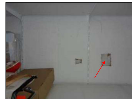
Foto 30: Opslag, begane grond: Wandbeplating (Bron 14) (Asbesthoudend)
