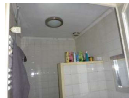
Foto 78: Badkamer: Ventilatiekanaal (Niet asbestverdacht)
