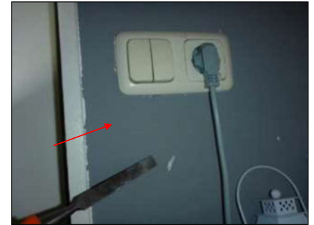
Foto 64: Pand, aanbouw begane grond: Wandbeplating (Bron 15) (Asbesthoudend)
