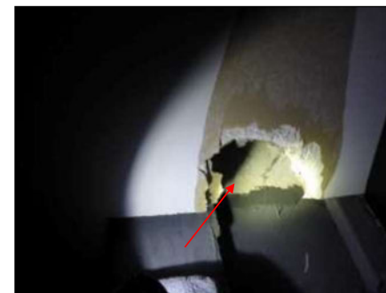
Foto 74: Pand, 1° etage, keuken: Wandbeplating (Bron 19) (Asbesthoudend) Zie conclusie hoofdstuk 7.
