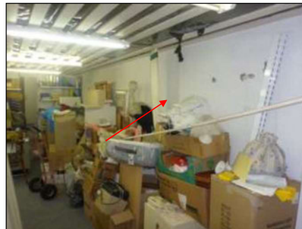
Foto 34: Opslag, begane grond: Wandbeplating (Bron 14) (Asbesthoudend)
