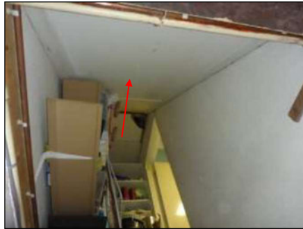
Foto 58: Pand, onderzijde trap: Trapbekleding (Bron 16) (Asbesthoudend)
