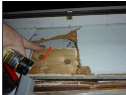
Foto 32: Opslag, begane grond: Wandbeplating (Bron 14) (Asbesthoudend)
