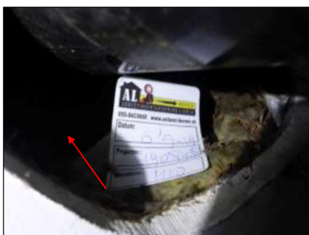
Foto 72: Pand: Dakbeschoot (Bron 9) (Asbesthoudend) Zie conclusie hoofdstuk 7.
