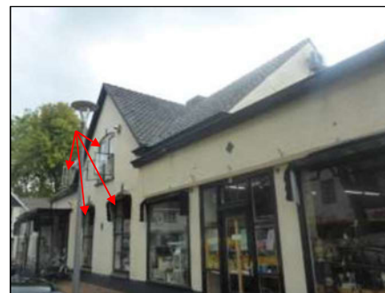
Foto 49: Winkelpand: Stopverf (Bron 17) (Asbesthoudend)
