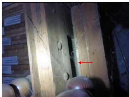
Foto 11: Opslag, 1 e etage: Deurbeplating (Bron 3) (Asbesthoudend)
