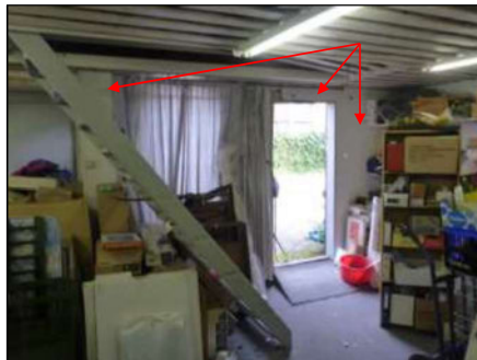
Foto 33: Opslag, begane grond: Wandbeplating (Bron 14) (Asbesthoudend)
