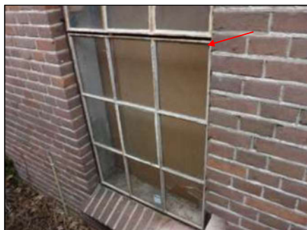
Foto 43: Opslag: Stopverf (Bron 7) (Asbesthoudend)
