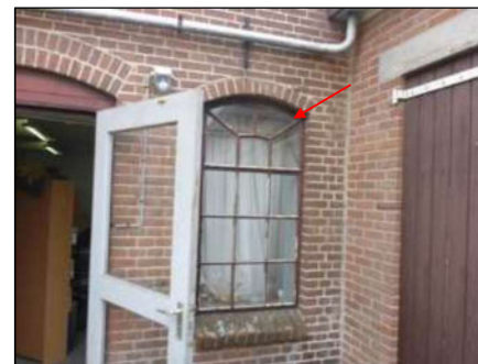
Foto 41: Opslag: Stopverf (Bron 7) (Asbesthoudend)
