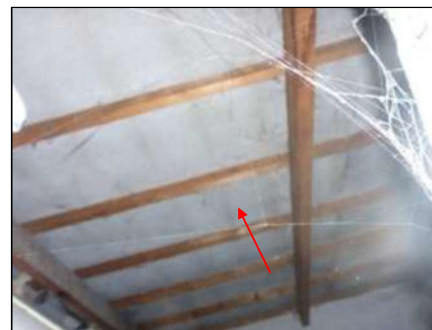
Foto 73: Pand: Dakbeschoot (Bron 9) (Asbesthoudend) Zie conclusie hoofdstuk 7.
