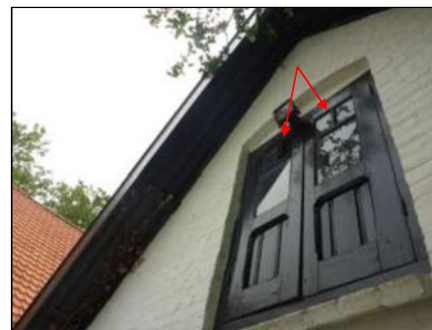
Foto 97: Schuur: Stopverf (Bron 18) (Asbesthoudend)
