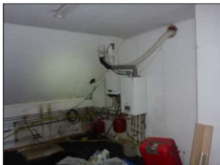
Foto 79: CV-ketels (Niet asbestverdacht)
