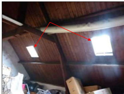
Foto 46: Opslag: Stopverf (Bron 7) (Asbesthoudend)
