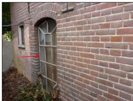
Foto 44: Opslag: Stopverf (Bron 7) (Asbesthoudend)
