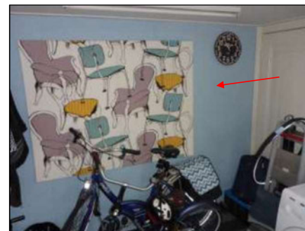
Foto 65: Pand, aanbouw begane grond: Wandbeplating (Bron 15) (Asbesthoudend)
