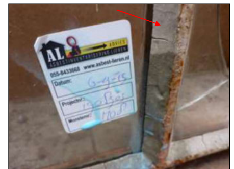
Foto 42: Opslag: Stopverf (Bron 7) (Asbesthoudend)
