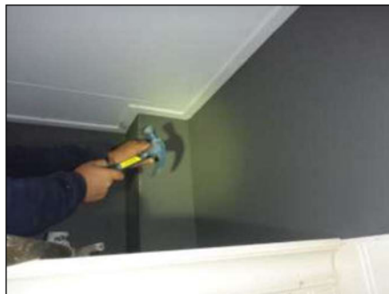
Foto 82: Koof: Destructief onderzoek (Niet asbestverdacht)
