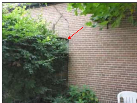
Foto 47: Opslag: Stopverf (Bron 7) (Asbesthoudend)
