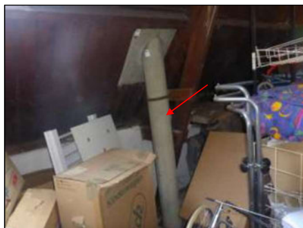
Foto 7: Opslag, 1 e etage: Buis (Bron 2) (Asbesthoudend)
