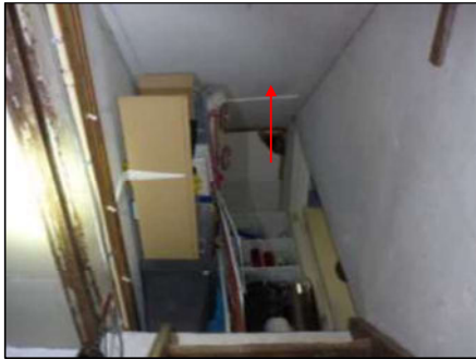
Foto 57: Pand, onderzijde trap: Trapbekleding (Bron 16) (Asbesthoudend)
