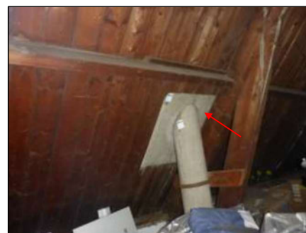
Foto 5: Opslag, 1 e etage: Plafondbeplating (Bron 1) (Asbesthoudend)
