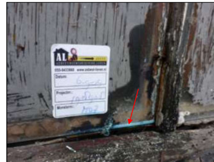
Foto 39: Opslag: Stopverf (Bron 7) (Asbesthoudend)
