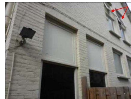
Foto 50: Winkelpand: Stopverf (Bron 17) (Asbesthoudend)
