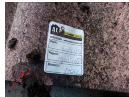
Foto 14: Garage: Golfplaten dak incl. overlap & toebehoren (Bron 4) (Asbesthoudend) Zie conclusie hoofdstuk 7.
