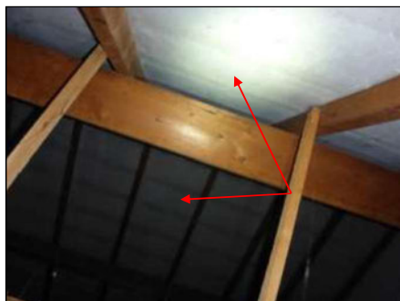
Foto 91: Pand: Dakbeschoot (Bron 9) (Asbesthoudend) Zie conclusie hoofdstuk 7.
