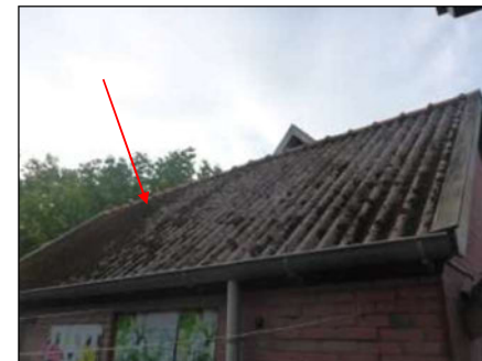
Foto 16: Garage: Golfplaten dak incl. overlap & toebehoren (Bron 4) (Asbesthoudend) Zie conclusie hoofdstuk 7.
