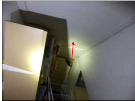
Foto 56: Pand, onderzijde trap: Trapbekleding (Bron 16) (Asbesthoudend)
