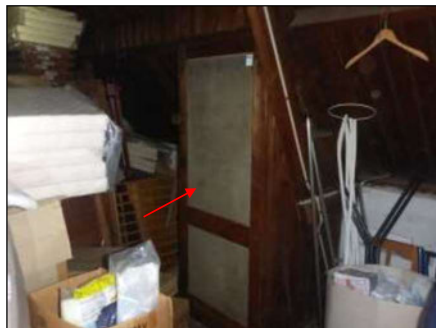
Foto 10: Opslag, 1 e etage: Deurbeplating (Bron 3) (Asbesthoudend)
