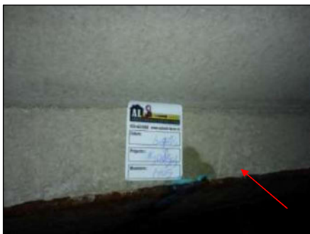
Foto 59: Pand, kelder: Verloren bekisting (Bron 9) (Asbesthoudend) Zie conclusie hoofdstuk 7.
