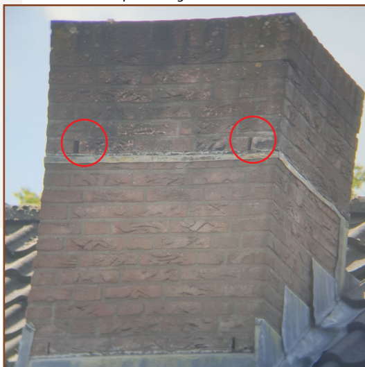
Afbeelding 11: De schoorsteen binnen het plangebied bevat open stootvoegen waardoor vleermuizen de luchtsponw kunnen betreden en kunnen gebruiken als vaste rust- en verblijfplaats.
