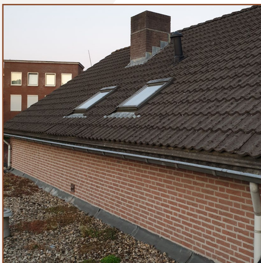
Afbeelding 15: Het achterste deel van het pand is ongeschikt voor huismussen doordat er niet genoeg ruimte aanwezig onder de pannen én de gootsteen te ver van de pannen af ligt.
