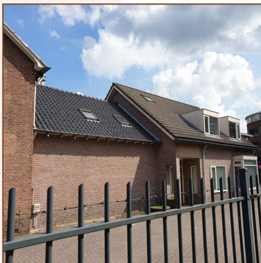
Afbeelding 9: Het pand bevat weliswaar een pannendak echter is deze na nadere inspectie ongeschikt voor huismussen.
