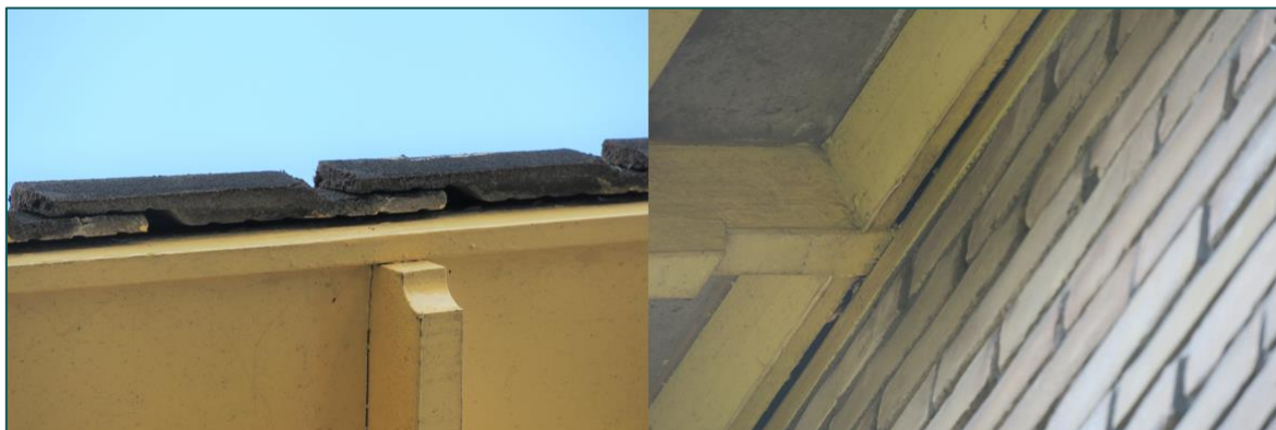
Figuur 3.1 De ruimte tussen de kantpannen (links) en de daklijst (rechts) kan vleermuizen toegang verlenen tot de dakruimte en spouwmuur.
