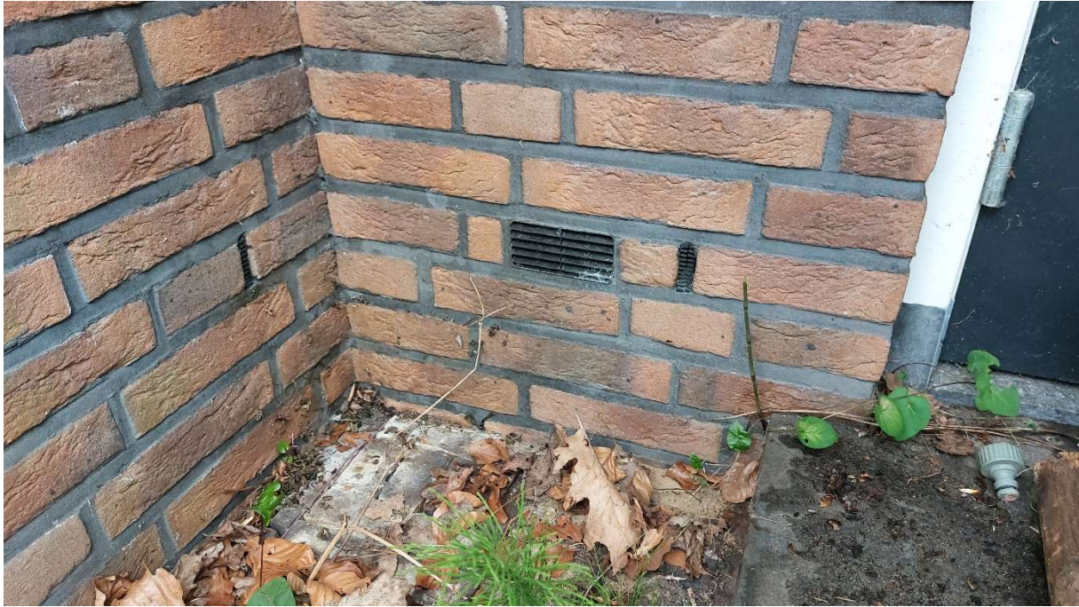
Rooster in stootvoeg en rooster in ventilatiekanaal kruipruimte
