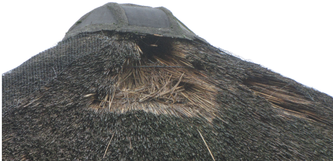
Figuur 9. Een van de gaten in het rieten dak.
