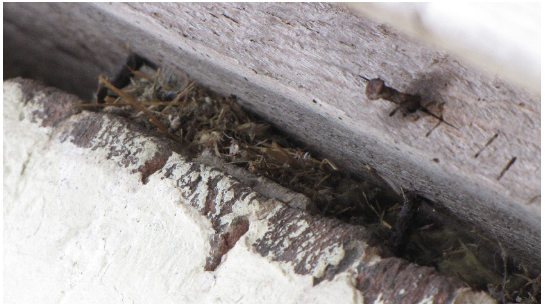
Figuur 10. Tussen de muur en de houten dakrand is nestmateriaal te zien.
