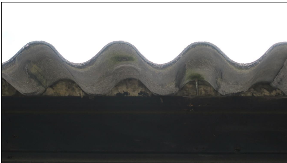
Figuur 3.3 Openingen tussen de houten wanden en het golfplaten dak zijn opgevuld met purschuim en derhalve niet toegankelijk voor huismussen.
