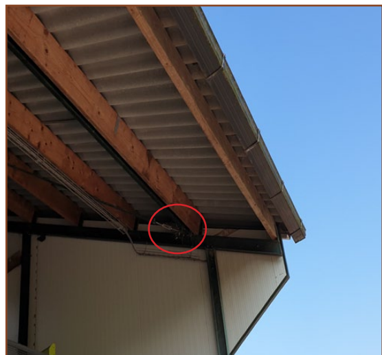
Afb. 2.4: Aan de westzijde van de uit te breiden schuur is een nest aanwezig van waarschijnlijk een Kauw.
