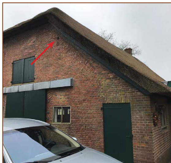
Afb. 2.3: De achtergevel van de boerderij met gaten in de gevel en een vrij recent vernieuwde rieten kap.
