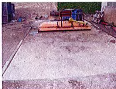
Foto 4: Wasplaats met ingemetselde peilbuis
