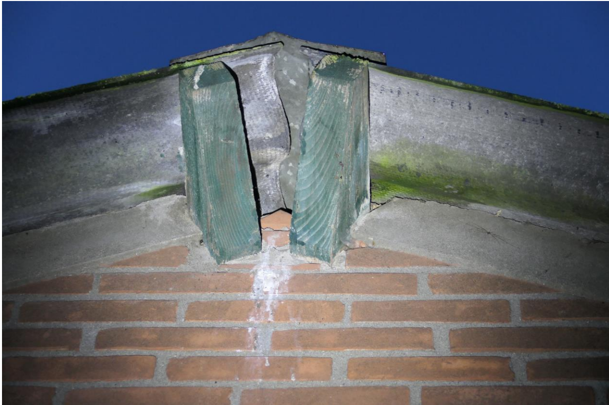
Figuur 4.4 Door de aanwezige houten balken is de opening bij de nok van de grote schuur niet toegankelijk voor gierzwaluw. Deze locatie is hoogstwaarschijnlijk wel in gebruik als slaaplocatie door een vogelsoort zonder jaarrond beschermd nest, zoals boomkruiper (bron: Eco Reest).
