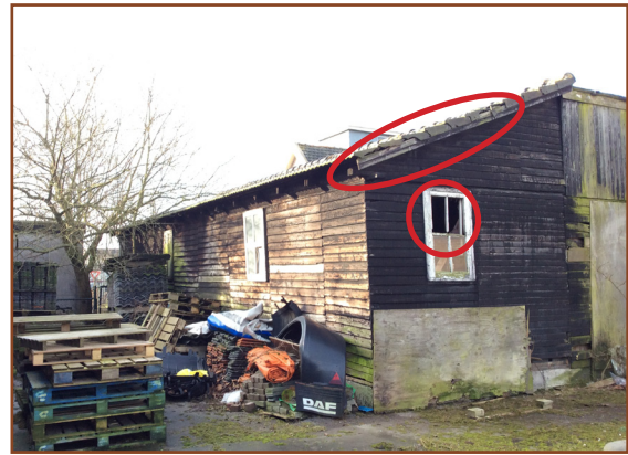
Afb. 2.3: Achterkant deels te slopen schuur met buitenopslag materiaal. In rood aangegeven beschadigd dakdeel en ruit die voorafgaand aan broedseizoen afgedicht moeten worden om broedgevallen te voorkomen.
