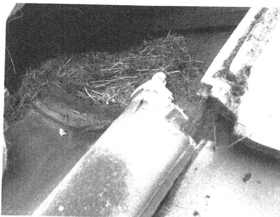
Foto 16: Nest van een huismus onder de dakpannen van de woning.
