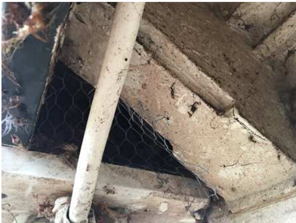
Inkruipopeningen in de woning zijn afgedicht. Mogelijk hebben de vorige bewoners deze maatregel genomen om de steenmarter buiten te houden.
