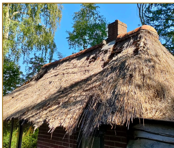
Afb. 2.5: Oude, zeer vervallen vakantiewoning in de hoek van het plangebied met grote gaten in het dak.
