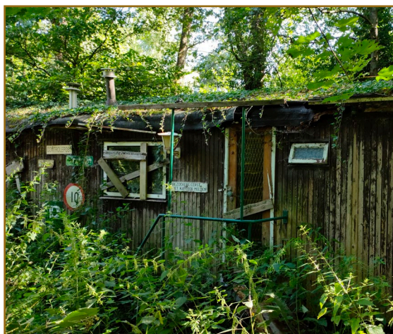
Afb. 2.13: Overwoekerde stacaravan. Ondanks de slechte staat zijn er geen openingen in de structuur waargenomen en ook nesten zijn er niet aangetroffen.
