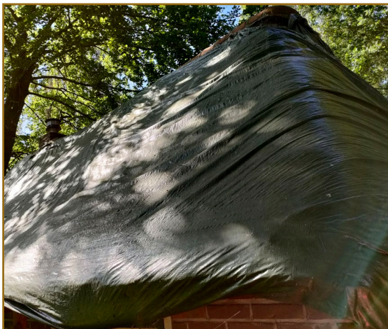
Afb. 2.9: Kapot dak van een te slopen vakantiewoning is strak ingepakt met zeil, waardoor er rondom geen openingen aanwezig zijn.
