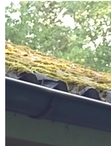
Foto 12: 5d Oude wc gebouw(asbest)
