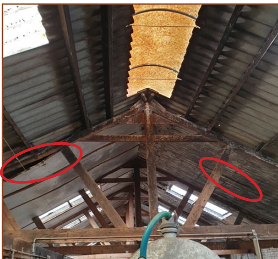
Afb. 2.3: De noordelijke stal heeft voor de helft wel isolatie onder de golfplaten. Deze ligt op veel delen los en kiert erg. Op een aantal plekken ontbreken stukken waardoor de stal ongeschikt is voor vleermuizen als verblijfplaats.
