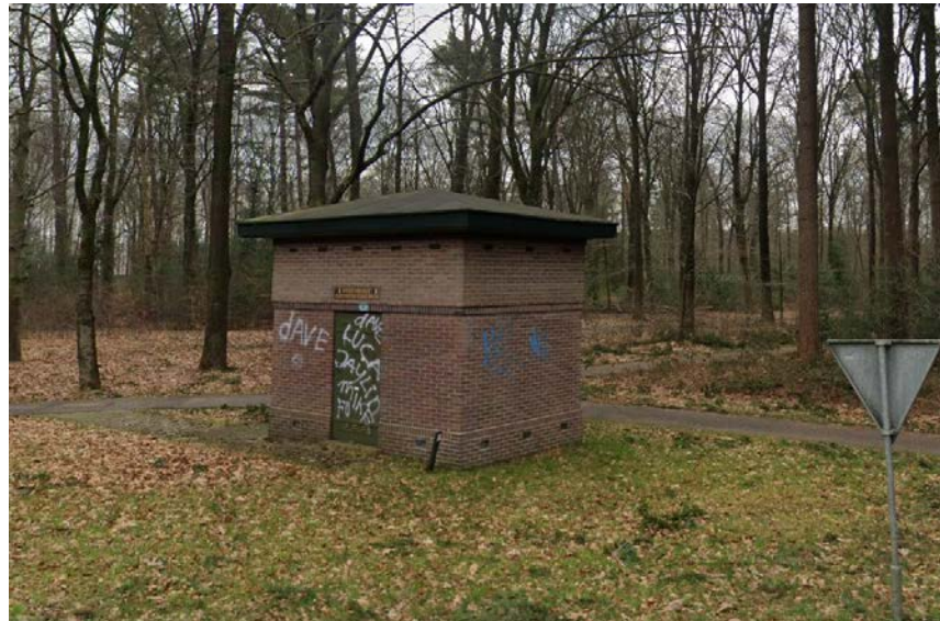
Standaard transformatorhuis tussen Epe en 't Harde
