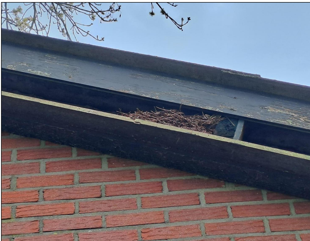
Aangetroffen nest van holenduif in een gleuf in de dak overstek van een van de varkensstallen.
