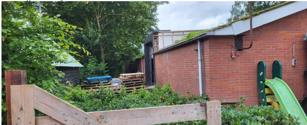
Foto 2: goot zuidzijde schuur C
