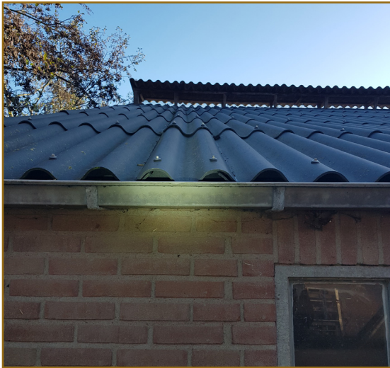
Afbeelding 2.7: Foto van de dichte openingen onder de golfplaten.
