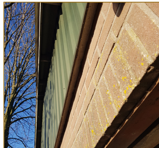
Afbeelding 2.12: Foto van de overgang van stenen muur naar metalen wandbeplating. Er is geen ruimte voor vleermuizen.
