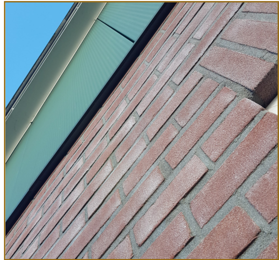
Afbeelding 2.8: Foto van de overgang van stenen muur naar metalen wandbeplating. Er is geen ruimte voor vleermuizen.
