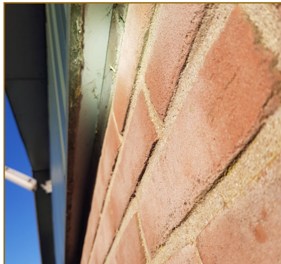
Afbeelding 2.9: Foto van de overgang van stenen muur naar metalen wandbeplating. Er is geen ruimte voor vleermuizen.
