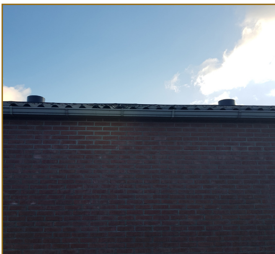
Afbeelding 2.5: Foto van de dichte openingen onder de golfplaten.
