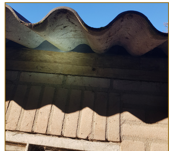
Afbeelding 2.6: Foto van de dichte openingen onder de golfplaten.
