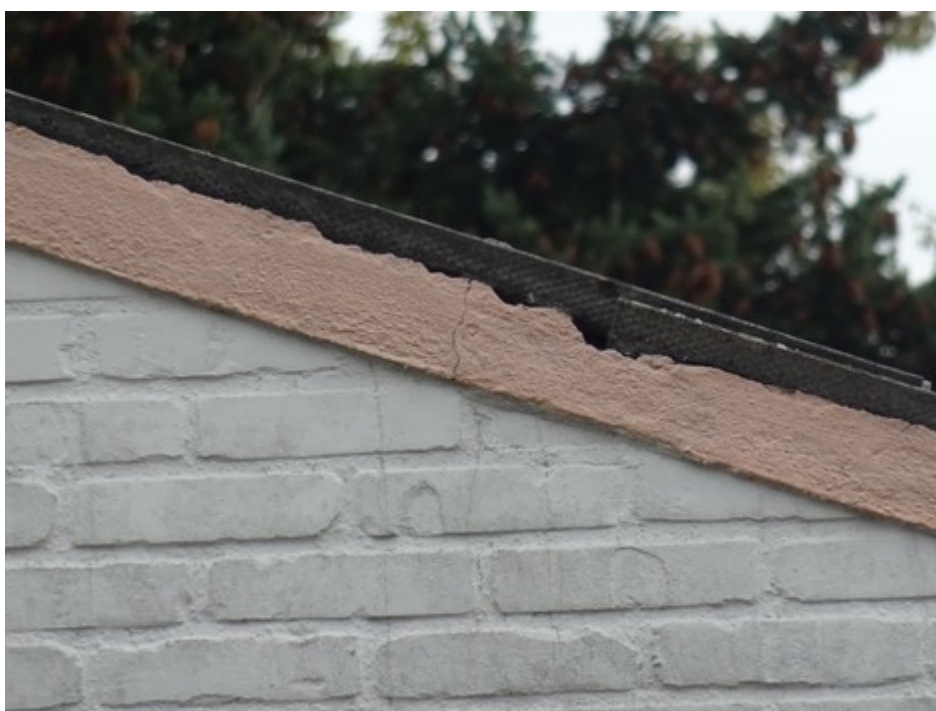
Afbeelding 5: Gaten en kieren in het bedrijfspannd bieden toegang tot de spouwmuur. Fotograaf: M Oomen, Ecoresult B.V.
