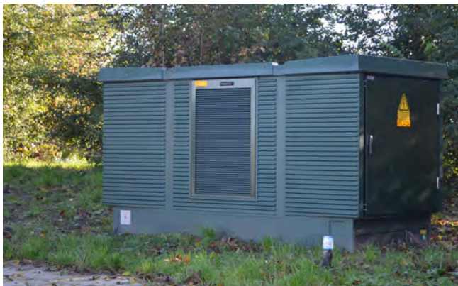
Afbeelding 27. Referentiebeeld transformator, Diabolo 5HL groen, bron: alfen.com.
