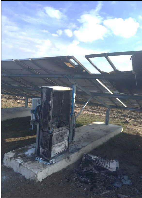
Figuur 7: Combiner box is uitgebrand
