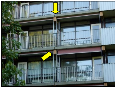
Figuur 14. Opening bij ieder balkon (overzicht). In één van deze plekken is een verblijfplaats van een gewone dwergvleermuis aanwezig.
