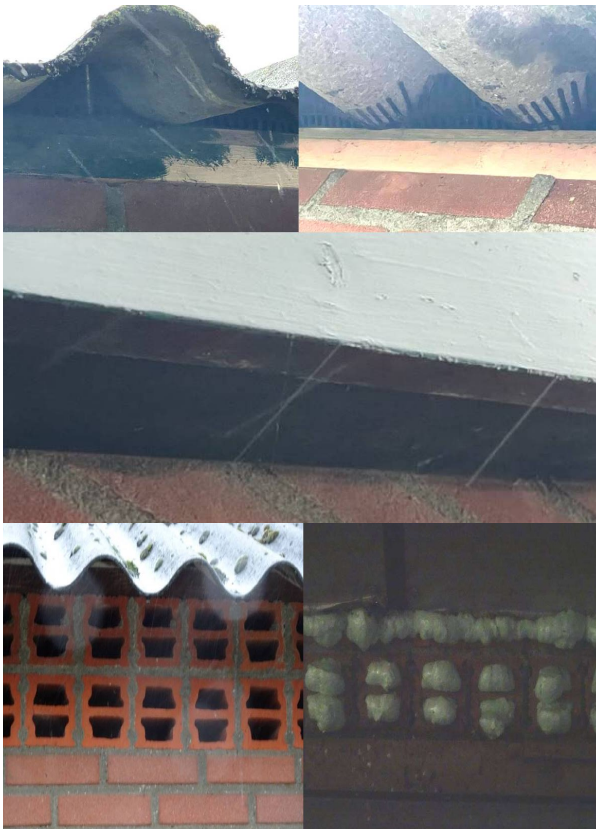
Figuur 6. Vogelwerende maatregelen (boven), geen geschikte mogelijkheden (midden) en gedichte openingen (onder) in de schuren aan de Klomperweg 101 te Lunteren, waardoor deze niet geschikt zijn als nestplaats voor de huismus.
