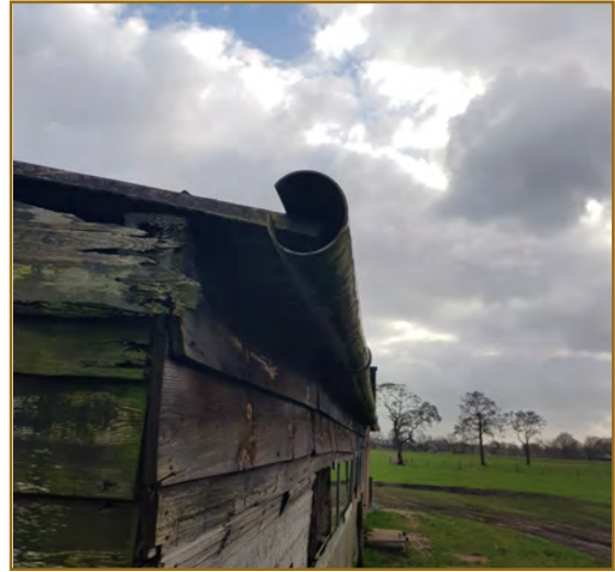
Afb. 2.14: Dakgoot/regenpijp van schuur 8 welke geen ruimte biedt aan nestplaatsen van huismussen.
