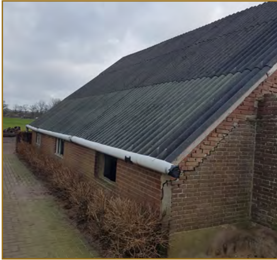
Afb. 2.13: Dakgoot/regenpijp van schuur 5 welke geen ruimte biedt aan nestplaatsen van huismussen.
