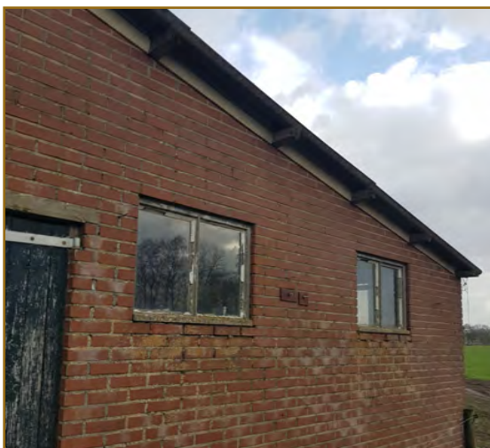
Afb. 2.5: Westkant van schuur 9. Geen ruimte voor vleermuizen om in de spouw te kruipen.
