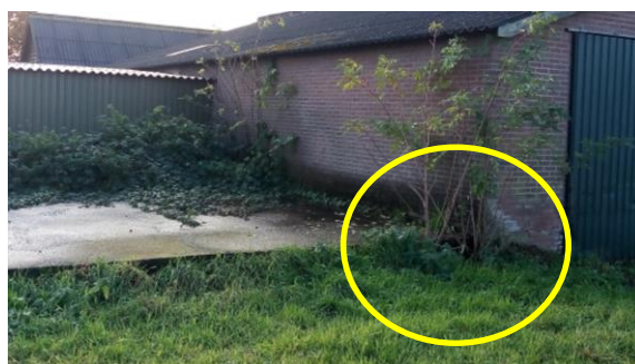
Foto 13: Noordoostelijk deel van de rundveestal: asbestverdachte dakbedekking welke ontwaterd op een onverhard terreindeel (gat 82).
