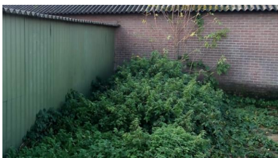
Foto 10: Achterzijde van de schuur op foto 6: asbestverdachte dakbedekking welke ontwaterd op een onverhard terreindeel (gaten 83, 84, 85).
