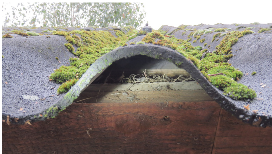
Afbeelding 13: Nestmateriaal (mogelijk van huismus) onder de dakbedekking van opstal D.
