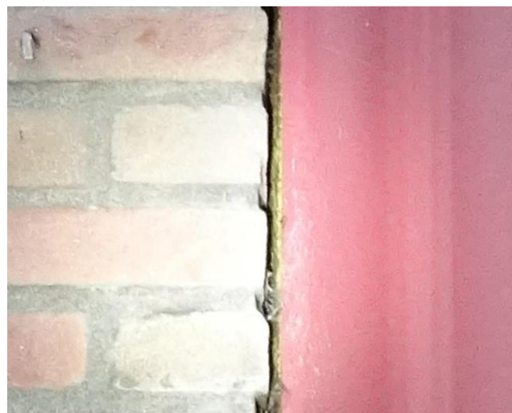
Afbeelding 4, de ruimte tussen de schuren welke niet doorloopt door het aanwezige isolatiemateriaal tussen de schuren (foto: Laneco, 2023).
